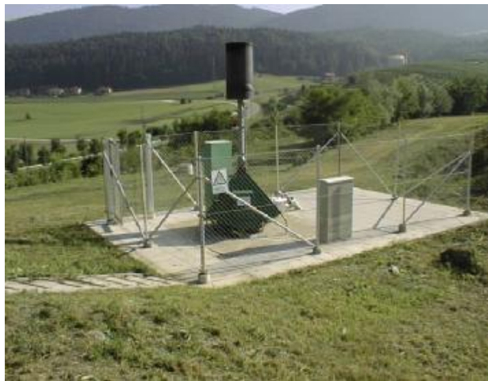
Slika 3.7: Odplinjevalna naprava na odlagališču v Velenju
