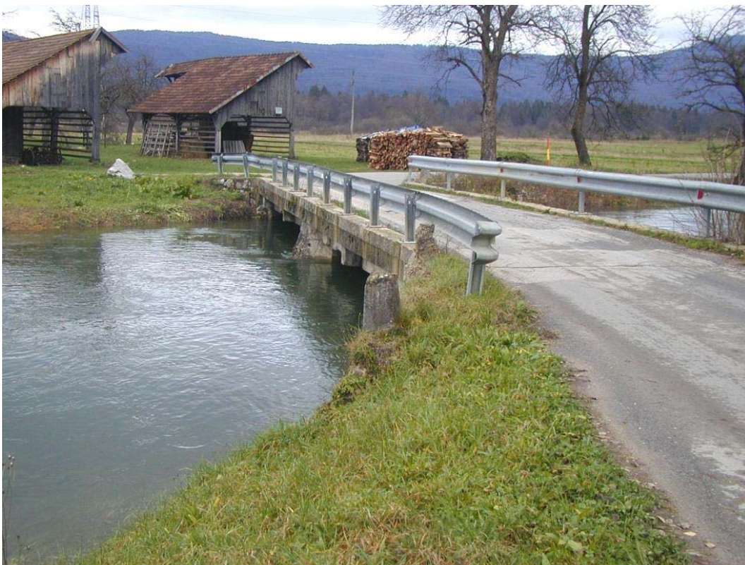
Slika 25: Premostitev lokalne ceste dne 23.11.2000 (Fazarinc, 2000)
