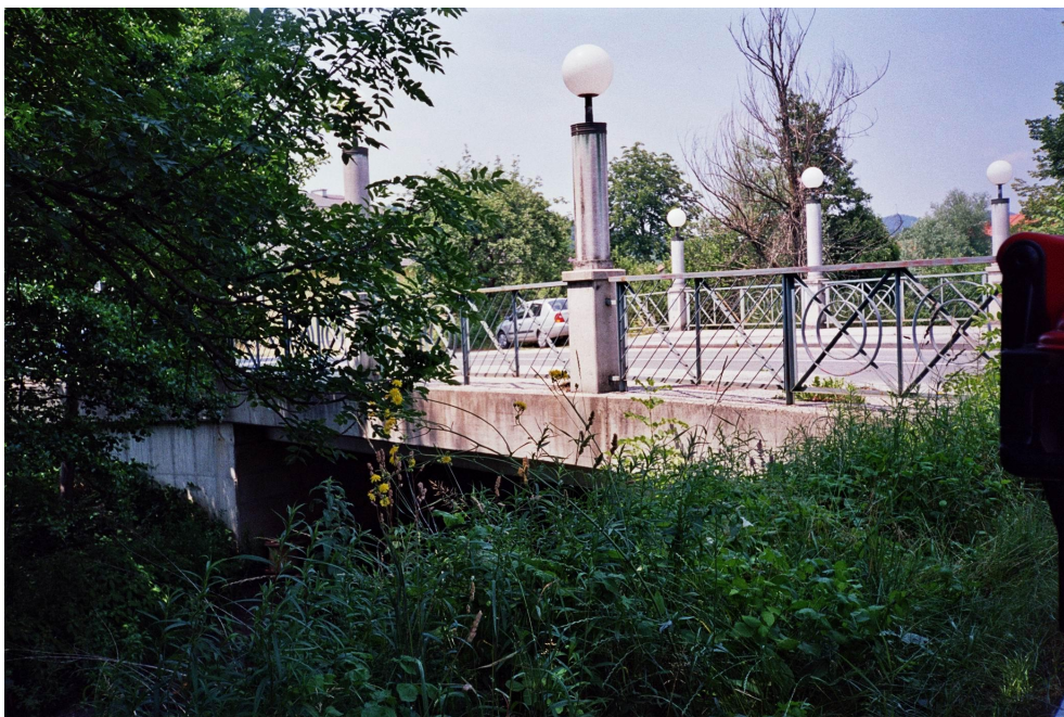
Slika 15: Most na Adamičevi cesti, dolvodno od mostu strugo zaraščajo črne jelše
