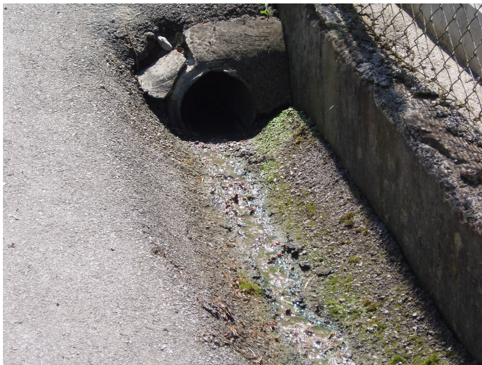
Slika 11: Obstoječa asfaltna mulda v naselju Laze, po kateri teče tudi greznična voda
