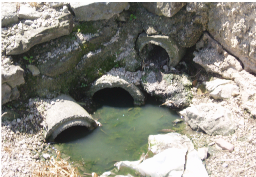
slika 9: Obstoječa vaška kanalizacija
