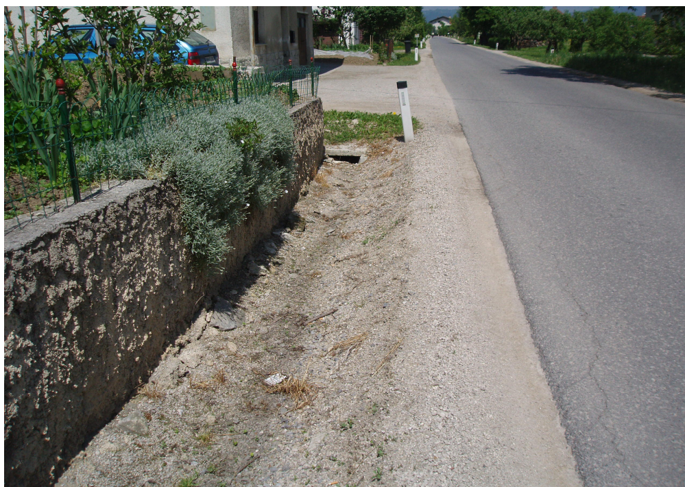
Slika 12: Obstoječ odprti graben ob regionalni cesti Vrhnika – Borovnica v naselju Dol
