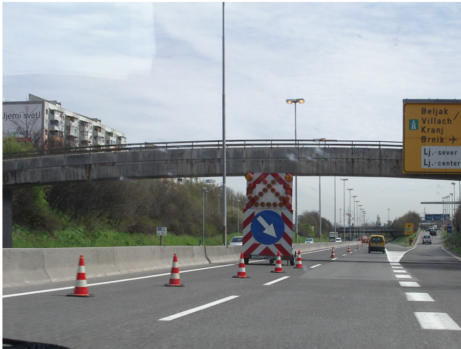
Slika: Optična signalizacije pri obnovi vozišča na obvoznica Ljubljana Sever (vir: foto Tadej Berčič)
