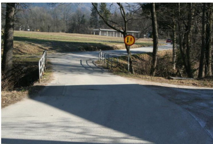
Slika 45: Dotrajan most na koncu Sr. Bele v smeri Zg. Bele. (slikano v nasprotni smeri stacionaže)
