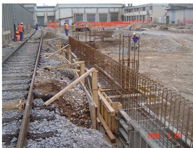
Slika 27: Pogled na razpiranje gradbene jame v osi A za potrebe zaščite obstoječega tira
