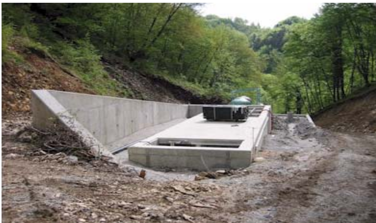
Slika 10: Čistilna naprava za izcedne vode na Regijskem odlagališču Unično
