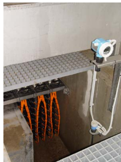
Slika 35: Sonda za merjenje nivoja vode (zgoraj) in sonda za zaščito pred suhim tekom (spodaj) – ČN Radovljica (MAK CMC, 2006)
