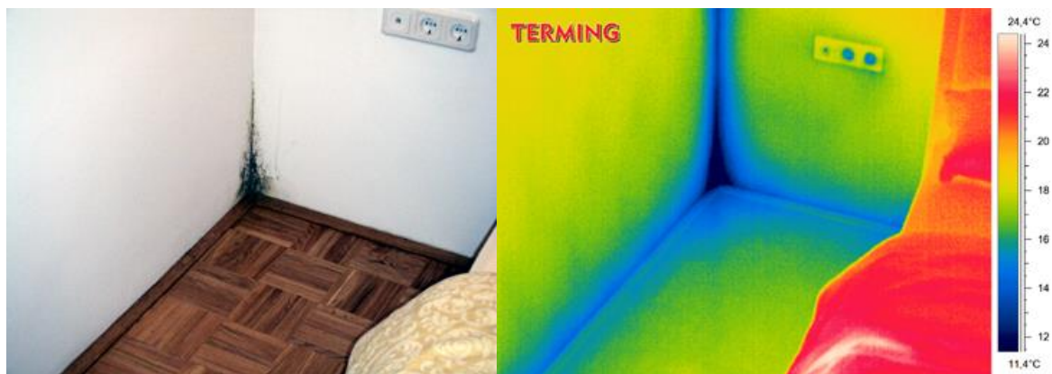
Slika 13: Posledice geometrijskega toplotnega mostu (Terming, 2016)
