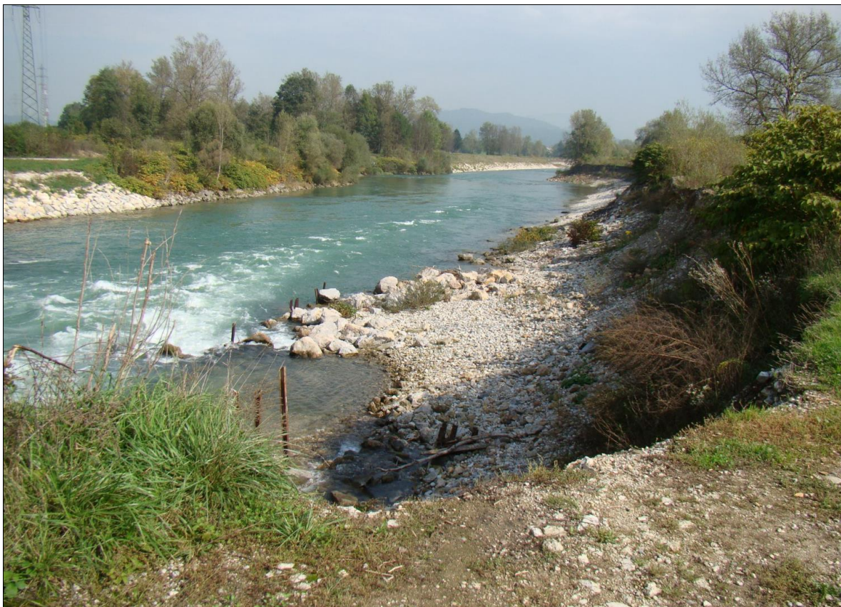
Slika 20: Močno erodirana desna brežina reke Save pri mostu avtoceste Ljubljana-Maribor na zaščiteneh območjih
