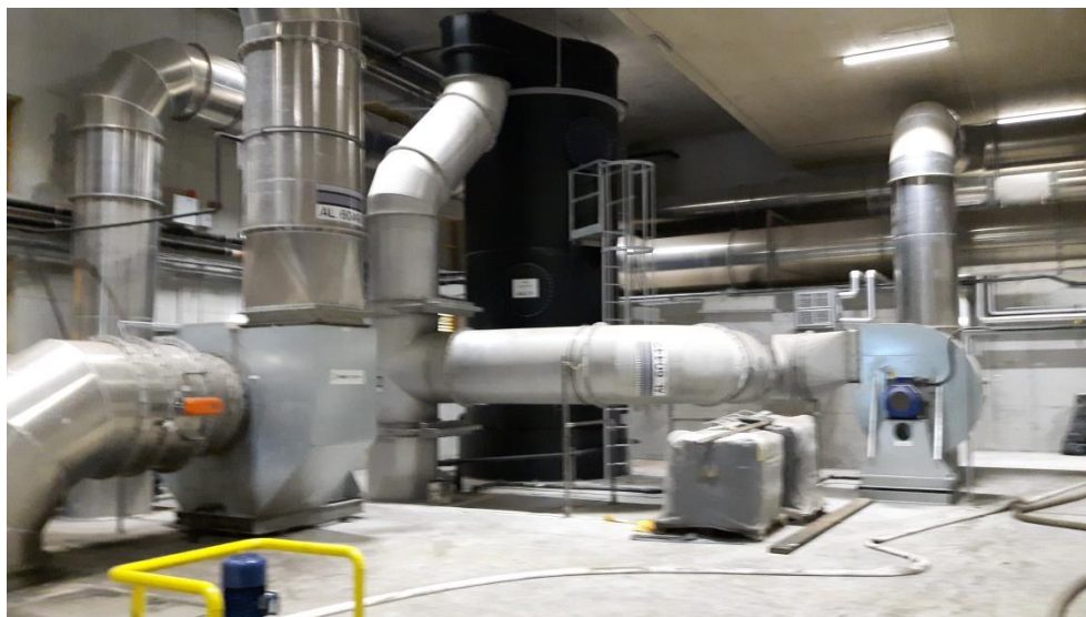
Slika 34: Pralnik plinov 604D31 in ventilatorji [vir: lasten]
