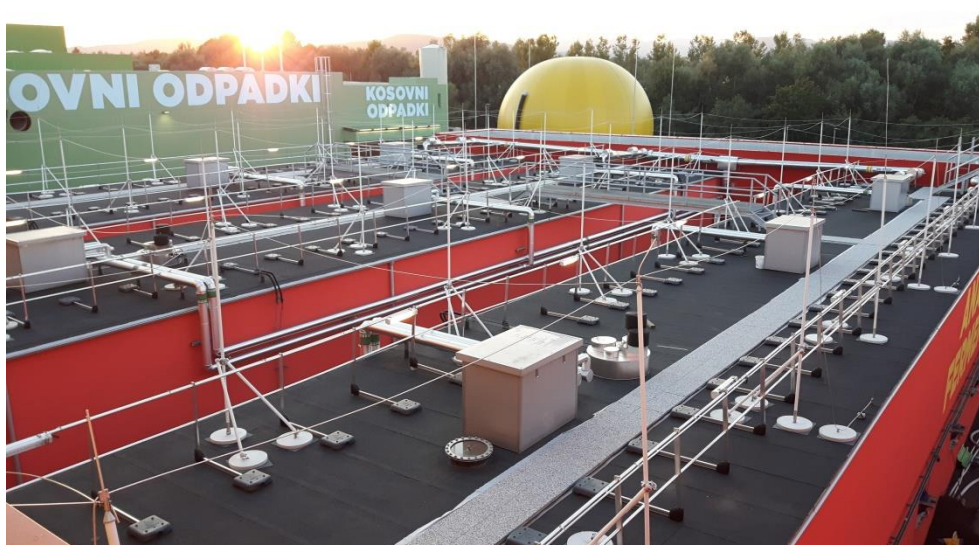
Slika 25: Fermenterji - pogled na streho z varnostnimi izpusti [vir: lasten]
