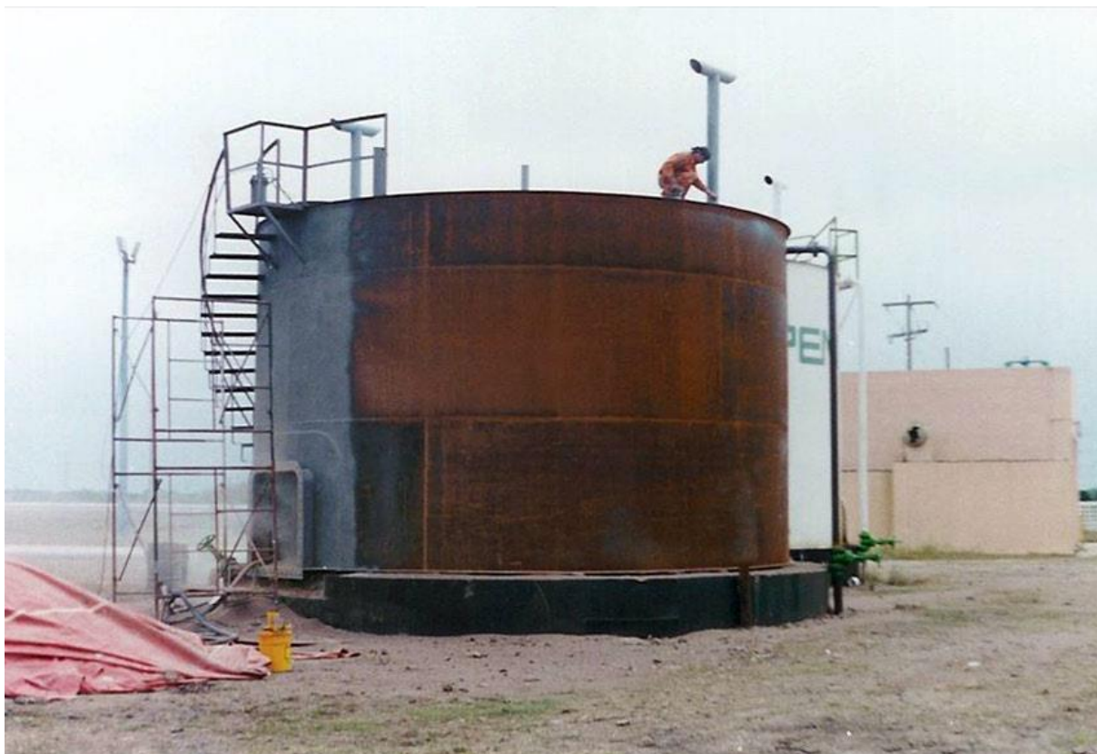
Slika 1.7: Primer poškodbe rezervoarja zaradi korozije na zunanji strani [7]
