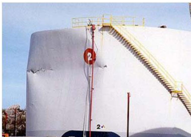
Slika 1.2: Poškodbe na rezervoarju zaradi vetra [2]
