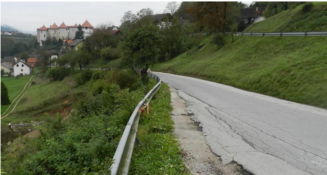
Slika 1: Poškodbe na obstoječem vozišču (CGP, d.d., 2015)
