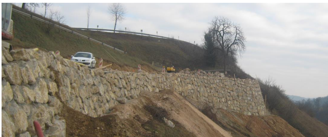
Slika 23: Kamnito-betonska zid od B15-B21 (CGP, d.d., 2016)
