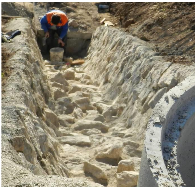
Slika 21: Prikaz izbočenih kamnov za umiritev pretoka meteorne vode – razbijači vode (CGP, d.d., 2016)
