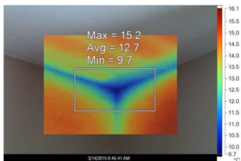
Stanovanje 4 (kot pri stropu)
