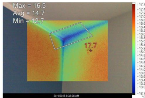
Stanovanje 3 (kot pri stropu)
