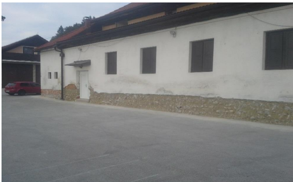
Slika 18: Dobro vidni sledovi poškodb vlage, dviga kapilarne vlage [21]
