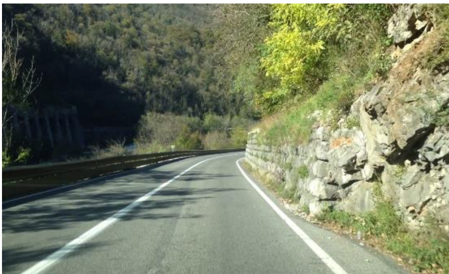
Slika 4.6: Primer kamnito-betonskega opornega zidu od km 3,500 do km 3,540, ki sega v prosti profil ceste, pogled v nasprotni smeri stacionaže
