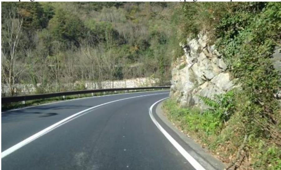
Slika 4.3: Nepregledna krivina od km 3,138 do km 3,377, pogled v nasprotni smeri stacionaže
