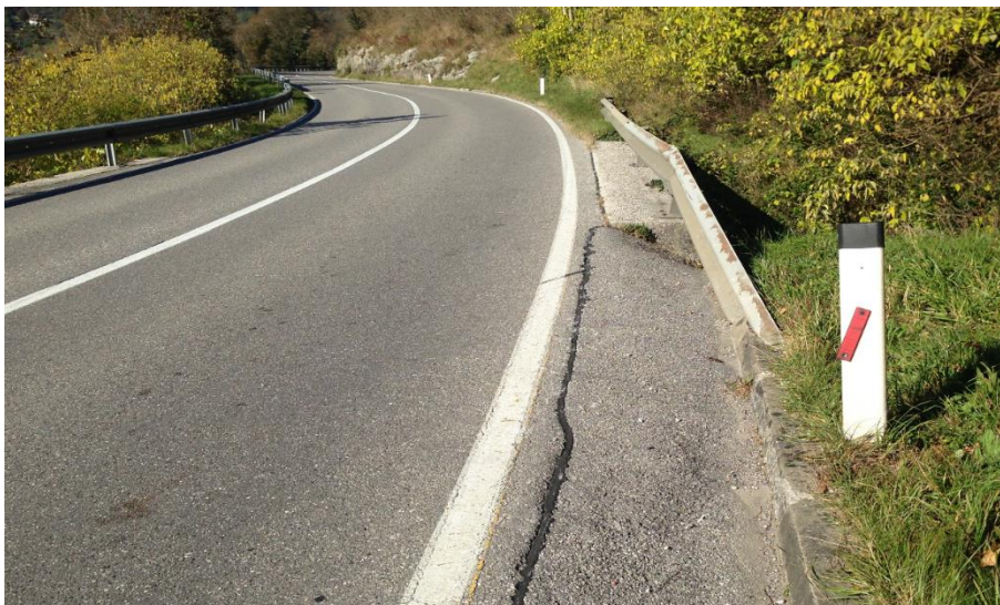
Slika 4.57: Primer poškodovanega smernika v km 0,695, pogled v nasprotni smeri stacionaže
