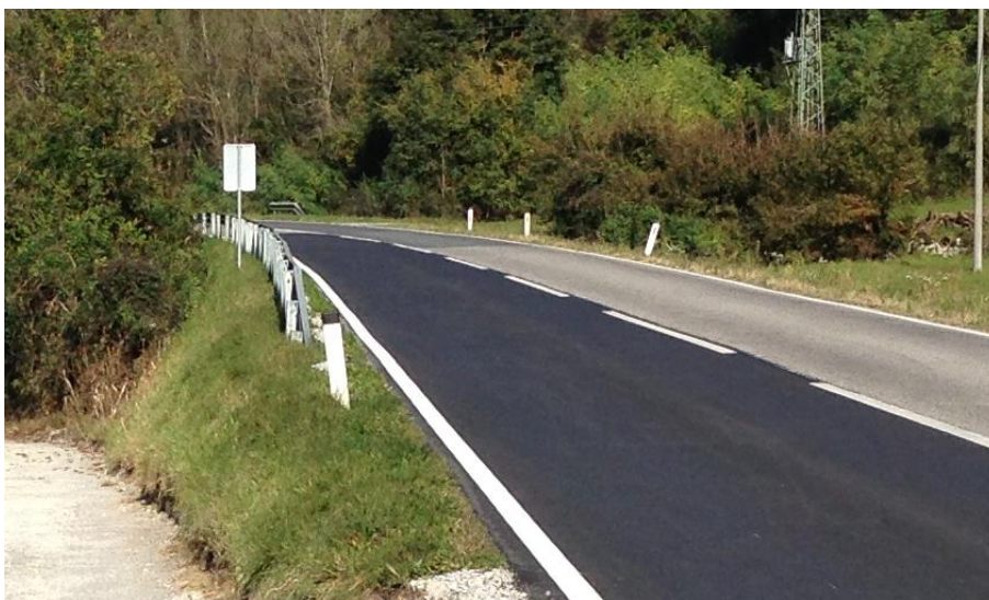
Slika 3.5: Primer preplastitve od km 1,110 do km 1,200 na desnem voznem pasu, pogled v nasprotni smeri stacionaže
