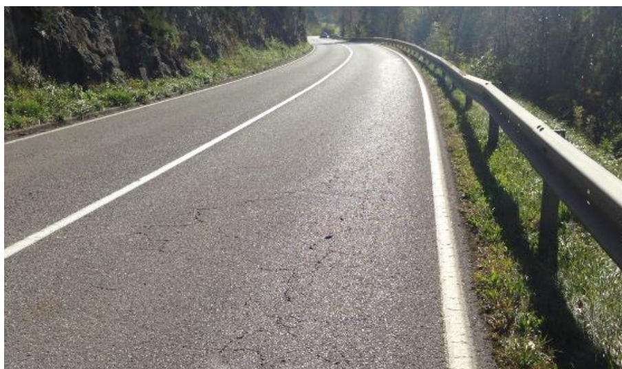
Slika 4.7: Poškodbe vozišča od km 0,760 do km 0,860, pogled v smeri stacionaže
