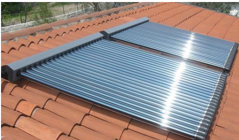
Slika 14: Solarni paneli (osebni arhiv)
