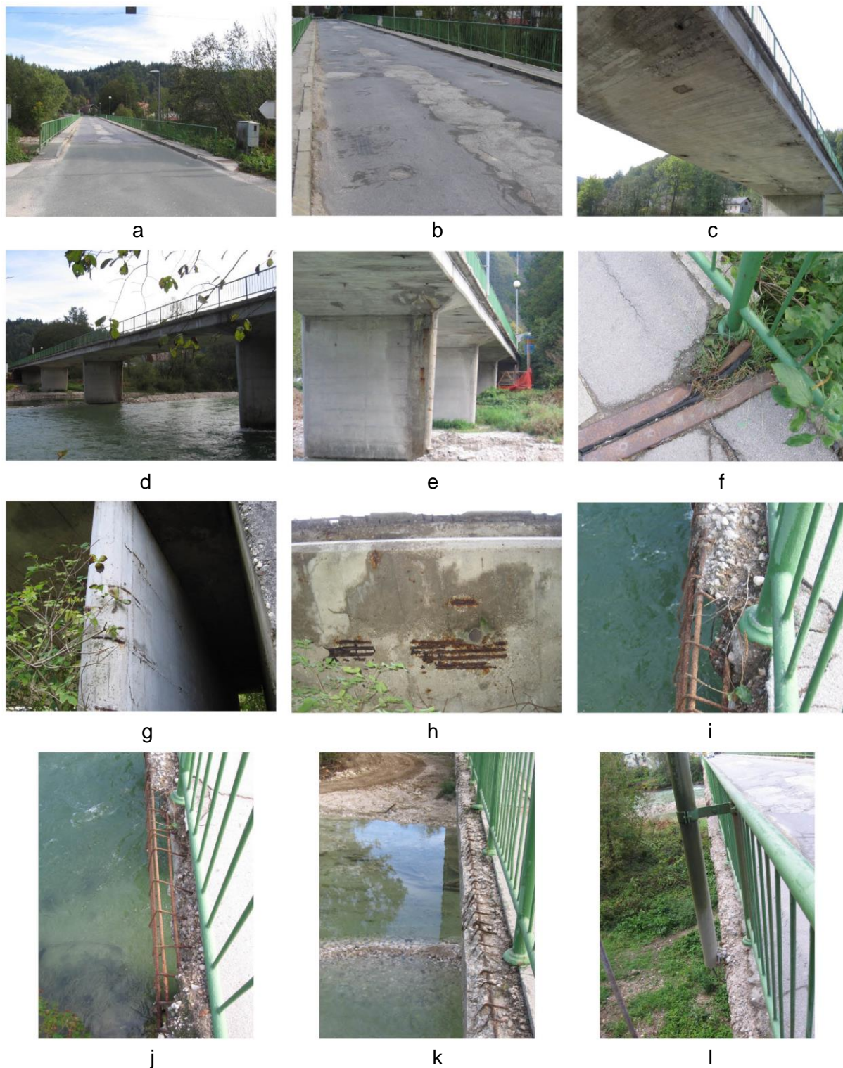
Slike 8: Slike poškodb mostu čez Savo v Podnartu: a) poškodbe vozišča, b) udarne jame na vozišču, c) napake betoniranja na nosilni plošči, d) poškodbe vmesnih opornikov, e) nezadostna debelina zaščitnega sloja betona na opornikih, f) poškodbe dilatacije, g) vidna armatura krajnih opornikov, h) korozija armature nosilne plošče, i) nepritrjeni stebrički ograje, j) razpad betona robnega venca, k) korozija armature robnega venca, l) nezadostno pritrjen drog javne razsvetljave (poročilo GI ZRMK)
