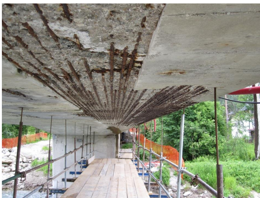
Slika 18: Odbijanje betona v območju nosilcev (lasten vir)
