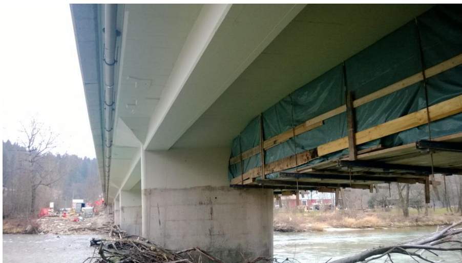
Slika 17: Odr za pranje konstrukcije, armiranje in opaženje nosilcev ter nanos zaščitnega premaza (lasten vir)
