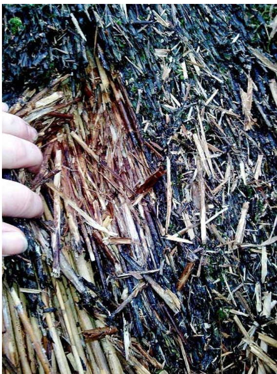
Slika 19: Poškodbe slamnate strehe zaradi prevelike vlage, ki se ni mogla izsušiti (Rieten dak, 2016)
