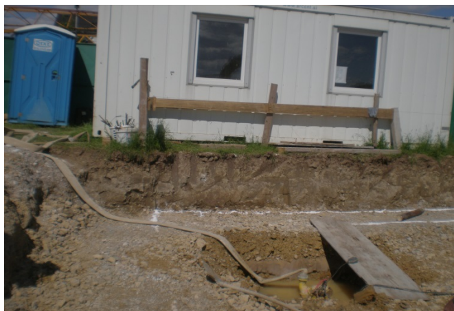
Slika 19: Slika prikazuje ureditev gradbišča s potrebnim gradbiščnim kontejnerjem za začasno pisarno in mobilnim straniščem
