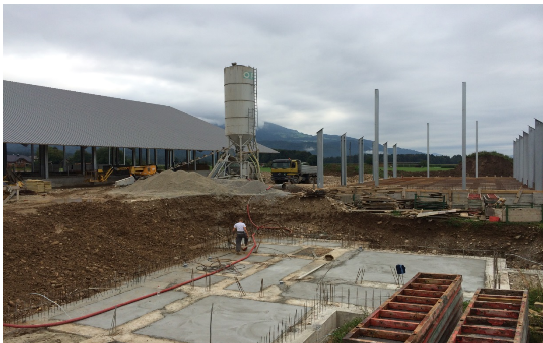
Slika 29: Na sliki je prikazana premična betonarna s silosom za cement
