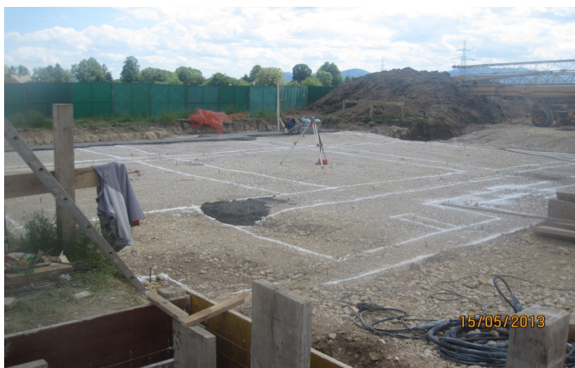
Slika 17: Na sliki je prikazano gradbišče ograjeno z panelno gradbiščno ograjo in zarisani temelji objekta
