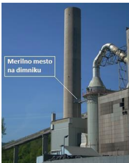
Slika 28: Dimnik peči in merilno mesto dimnih plinov [23]
