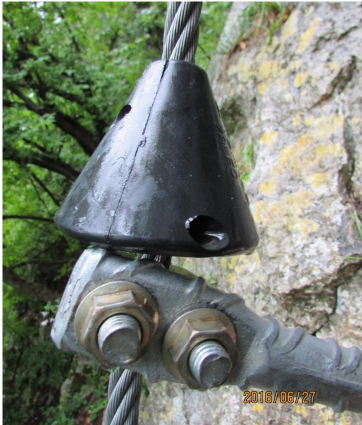
Slika 22: Vgrajen gumijasti varnostni stožec v Gonžarjevi peči
