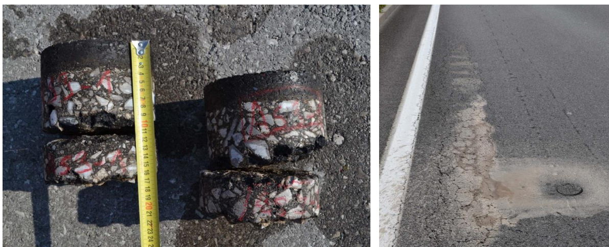
Slika 4-6 Primer neustrezne zlepljenosti asfaltnih plasti in mrežaste razpoke vozišča
