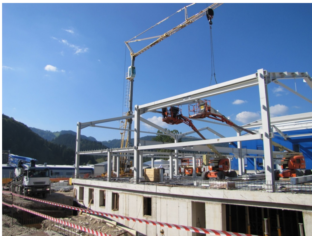
Slika 10: Pogled na gradbeno mehanizacijo, ki smo jo uporabljali pri gradnji (črpalka za beton, visoki žerjav, teleskopske dvizne ploščadi)
