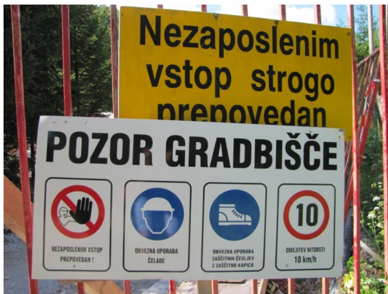
Slika 4: Opozorilna tabla na vhodu gradbišča.
