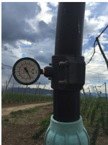
Slika 13: Manometer, nameščen na dovodni cevi (foto: Bosnar, 2016)
