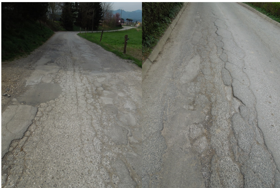
Slika 8: Poškodovana voziščna površina
