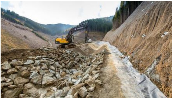
Slika 35: Gradnja korita prestavljenega potoka Longsbach Figure 35: The bed construction of the displaced Longsbach stream (vir: Bildergalerie Baustraßen Gemeinde Spital & Vorarbeiten Deponie Longsgraben http://www.oebb.at/infrastruktur/ , 2014)
