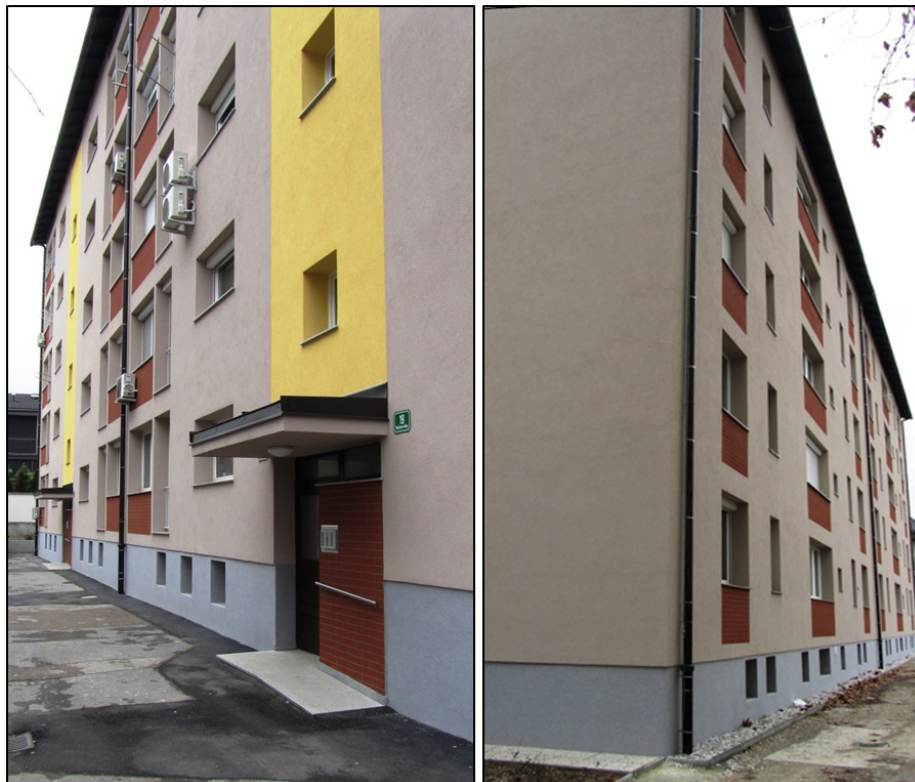
Slika 46: Pogled na zahodno in vzhodno fasado obravnavane stavbe po izvedeni energetske sanaciji
