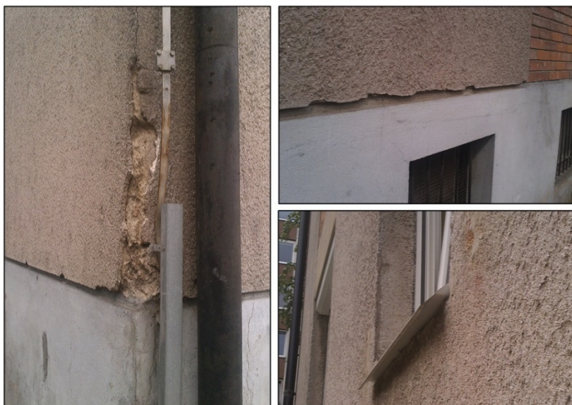
Slika 20: Poškodbe na fasadi stavbe in detajl okenske police
