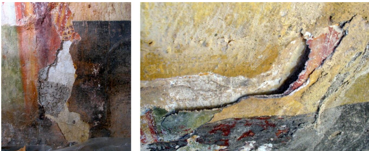
Slika 2.6: Godešič, cerkev sv. Miklavža, odpadanje in odstopanje ometa zaradi delovanja kapilarne vlage (levo). Detajl odstopajoče plasti ometa od stene (desno) (Kavčič, 2008).
