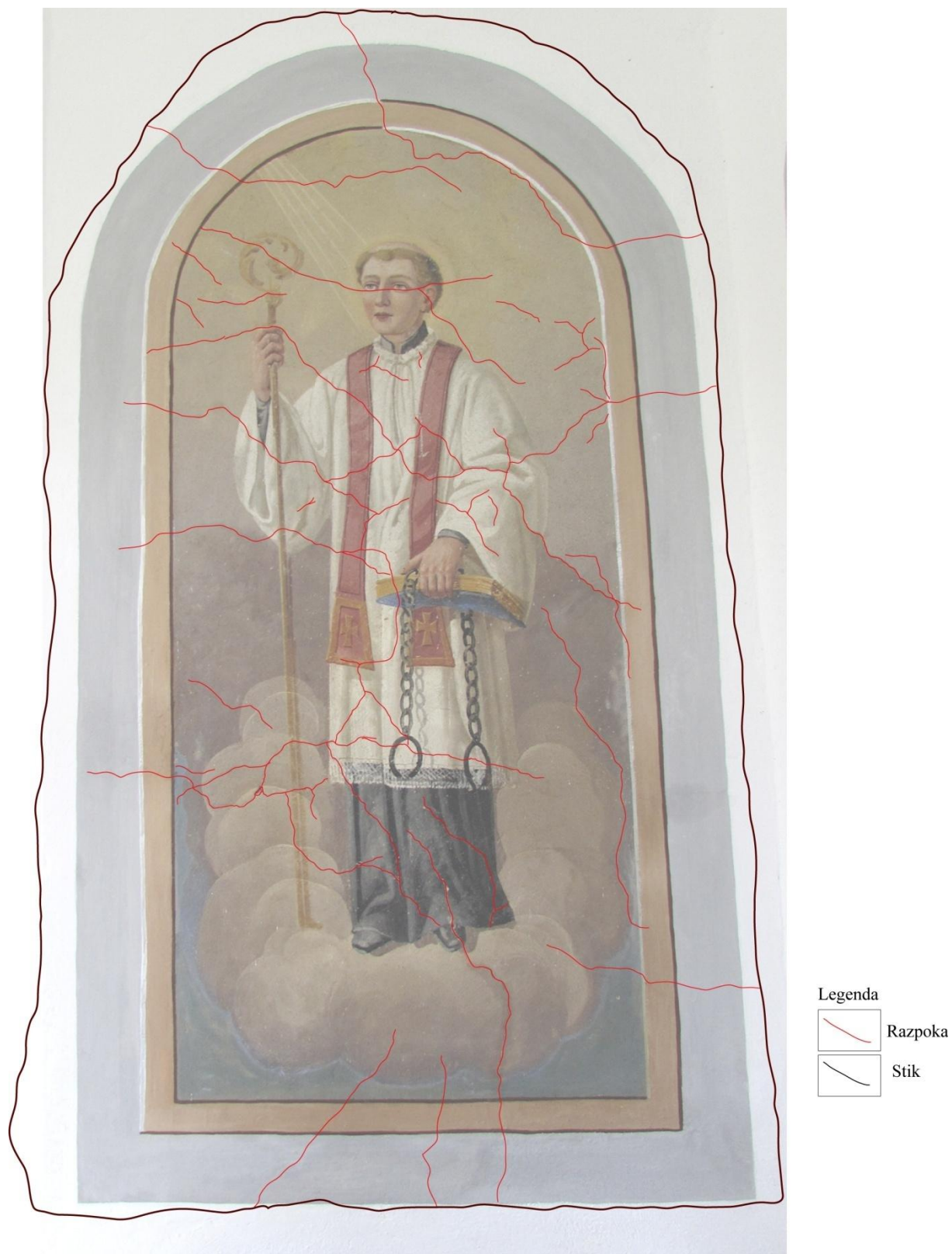
Slika L.3: Grafični prikaz razpok. Figure L.3: Graphic documentation of the cracks.
