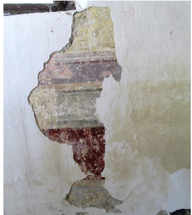
Rdeča puščica kaže odstopljeno plast ometa od opeke.
