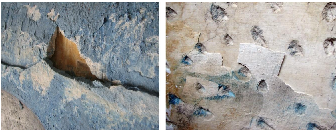
Slika 2.8: Soča, cerkev sv. Jožefa, odstopanje ometa zaradi nepravilne priprave površine pred nanosom nove plasti ometa. Detajl nivojske razpoke (levo) in naključna površina z ostanki beležev, na katero je bila nanešena nova plast ometa s poslikavo (desno).
