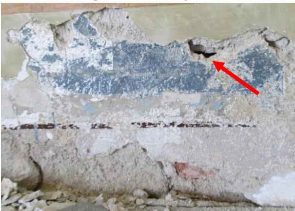
Slika L.2: Prikaz poškodbe zaradi prekomerne vlage v zidovih.
