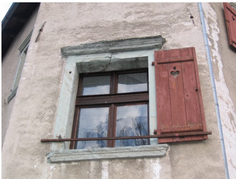
Slika 12: Okno s poškodovanim kamnitim portalom (ZRMK 2007)
