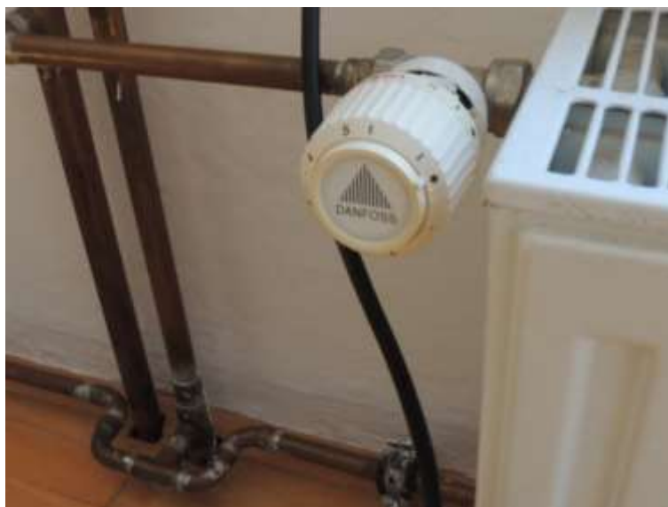
Slika 71: Vgrajena glava s termostatskim ventilom na radiatorju v pisarni
