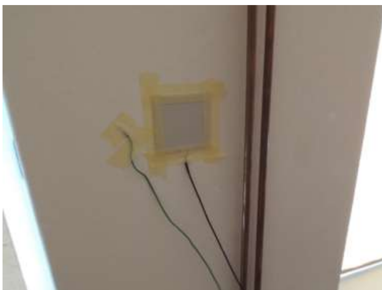
Slika 64: Pritrditev ploščice za izmero prehoda toplotnega toka v steni
