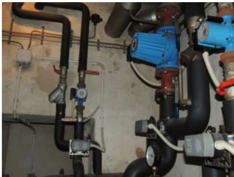
Slika 70: Razvodni sistem v kotlovnici
