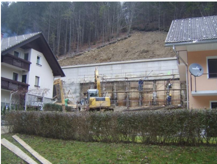
Slika 27: Vežanje armature in opaženje druge etape zidu pod betonsko gredo (lasten vir)
