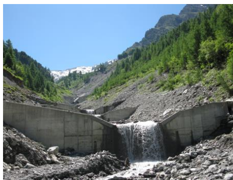
Slika 17: Niz konsolidacijskih pregrad za stabilizacijo hudourniškega območja (IRSTEA, 2011).
