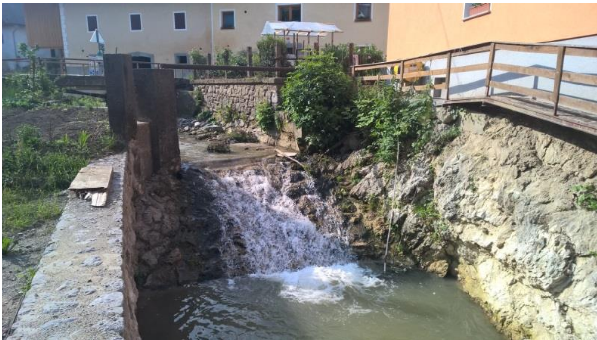
Slika 13: Drča na Hotoveljščici v spodnjem delu (avtor, terenski ogled, 1.6.2015).
