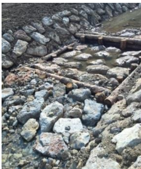
Slika 42: Novo zgrajen talni prag s krilnim lesom na potoku Hotoveljščica (avtor, terenski ogled, 1.6.2015).
