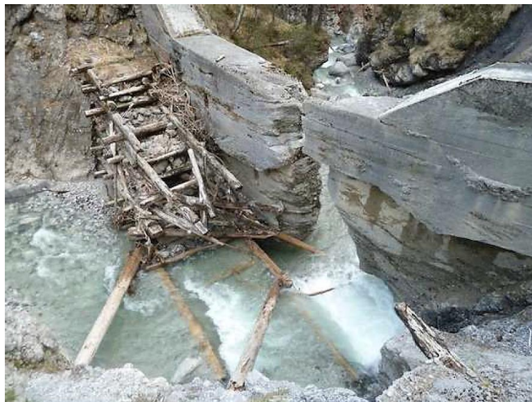
Slika 44: Hudourniška pregrada na Belci v km 2,48 (Martinčič, 2012).
