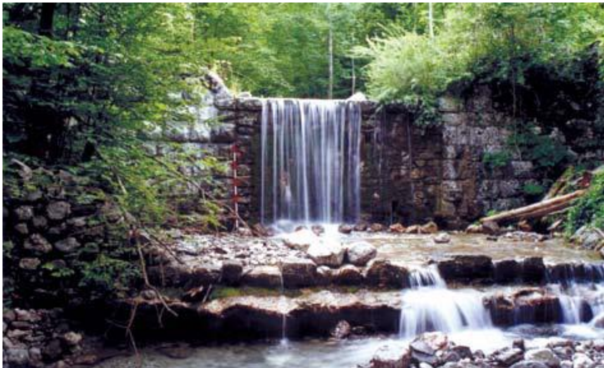
Slika 7: Več kakor sto let stara hudourniška pregrada, zidana v cementni malti (hudournik Šijak), (UJMA, 2008).
