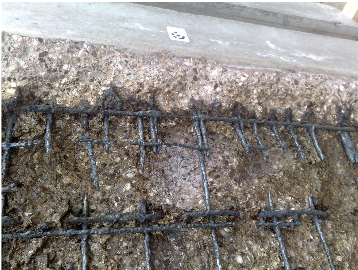
Slika 2.1: Posledice eksplozivnega luščenja betona. Viskozno lezenje armature. (Foto: osebni arhiv Bratina (2009)).
