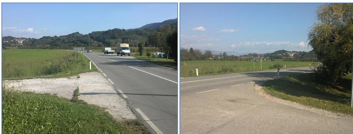
Slika 3: neustrezna navezava na GPS (levo) in prevelik vzdolžni nagib pri priključevanju na GPS (desno)
