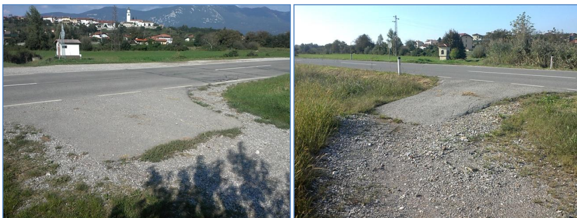
Slika 4: neustrezna in pomanjkljiva navezava priključkov na GPS
