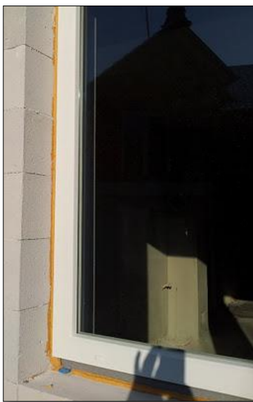
Slika 11: Primer nepravilno montiranega okna pri novogradnji (Kokot, M. 2011)
