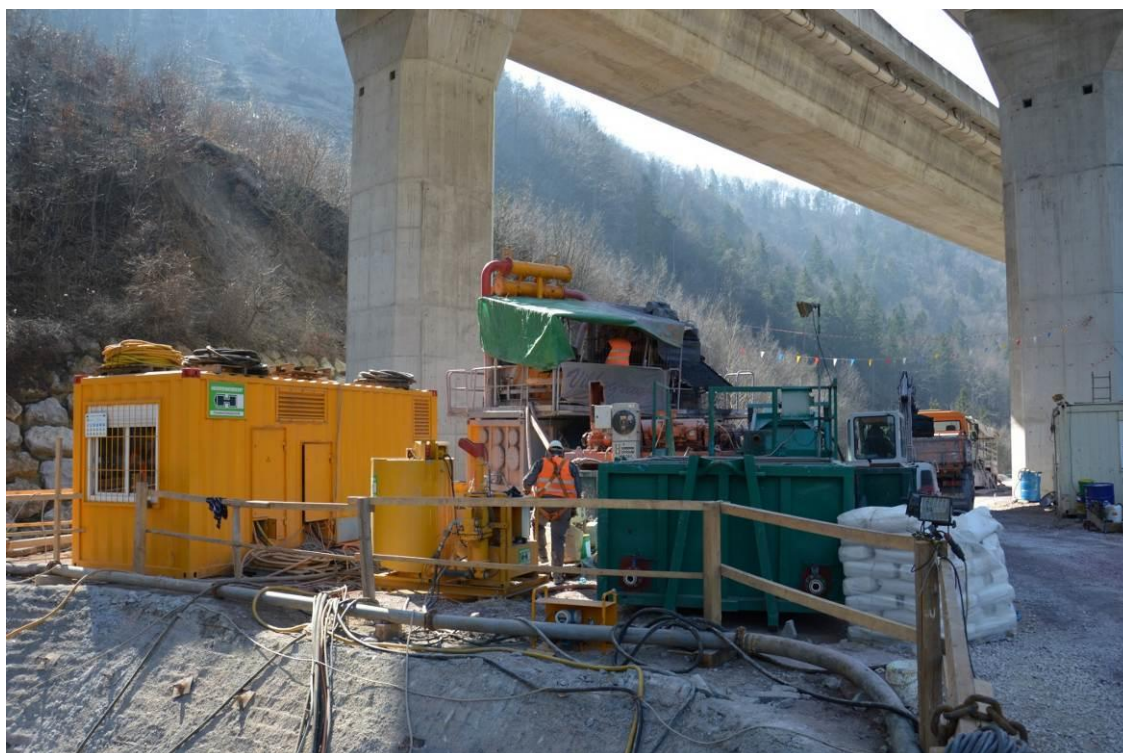
Slika 51: Kontejner za nadzor in krmiljenje ter reciklirna naprava, [lasten arhiv]
