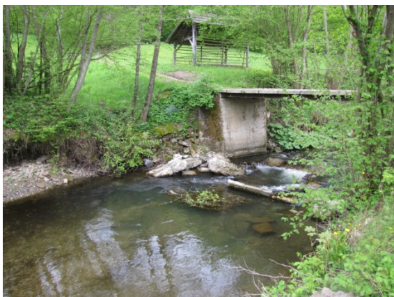
Slika 14: Betonni most čez Ločivnico v slabem stanju (Avtor, terenski ogled, 24.4.2014)
