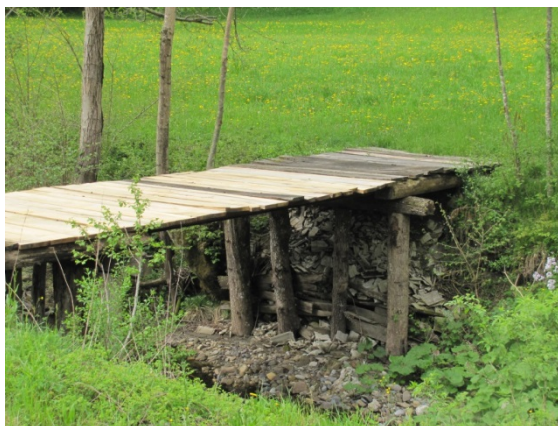
Slika 15: Leseni most čez Ločivnico v slabem stanju (Avtor, terenski ogled, 24.4.2014)
