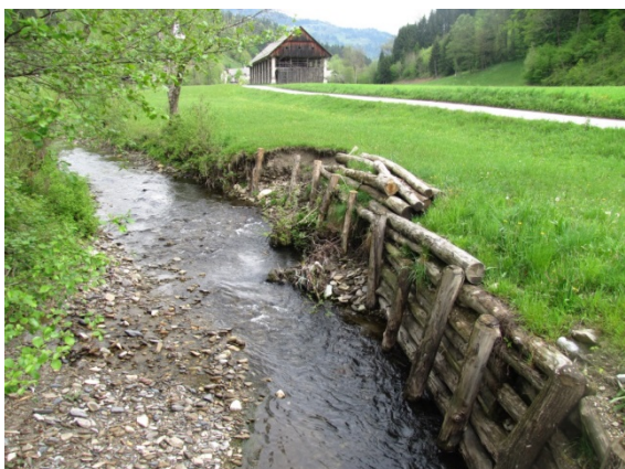
Slika 16: Poškodovana ureditev brežin (Avtor, terenski ogled, 24.4.2014)
