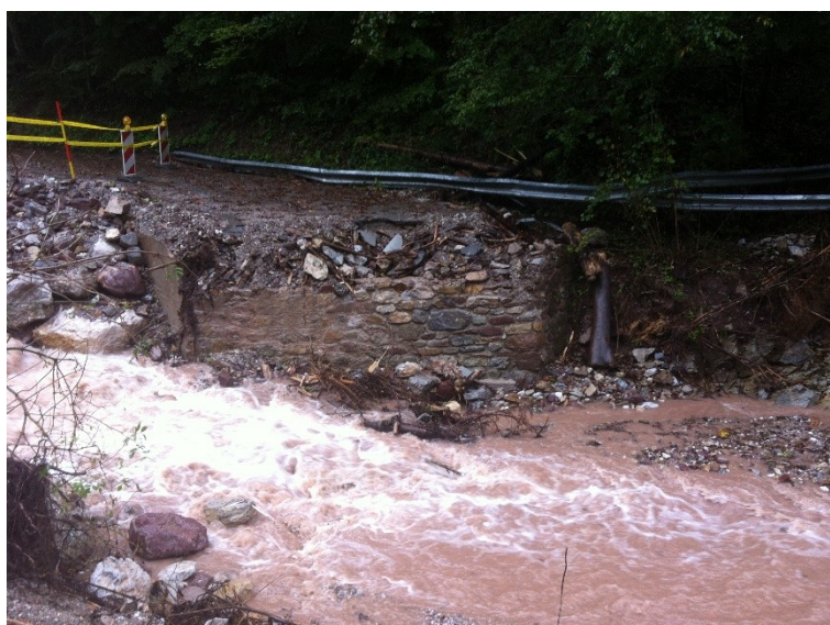
Slika 30: Ostanki porušenega mostu ob Gradaščici (foto: Nejc Žura)
