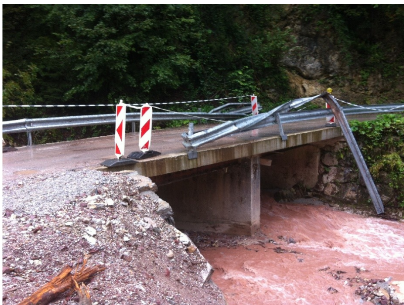
Slika 28: Poškodovan most zaradi odlaganja plavin na voziščno konstrukcijo (foto: Nejc Žura)
