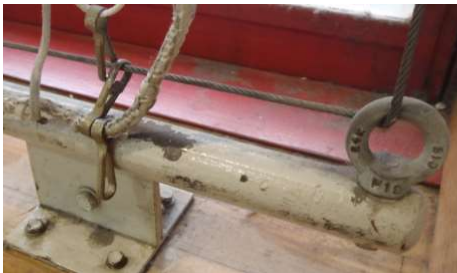
Slika 30: Neustrezni zatiči požarnih vrat po prenovi, leto 2013, (lastni vir).
