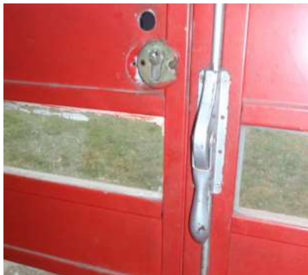
Slika 31: Neustrezna kljuka požarnih vrat po prenovi, leto 2013 (lastni vir).
