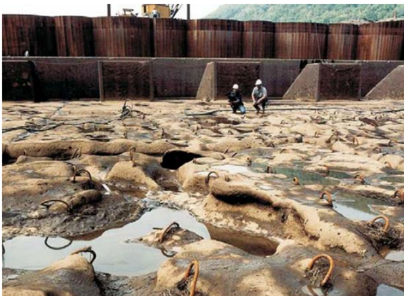
Slika 10: Poškodbe v podslapju pregrade Kinuza Dam (Kenal Chemical)
