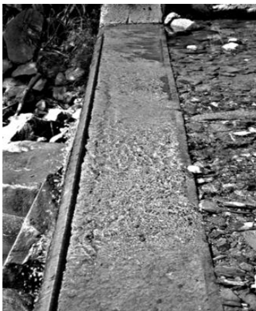
Slika 8: Poškodba prelivne sekcije betonske hudourniške pregrade zaradi delovanja abrazije (Jacobs et al, 2001: str. 32)
