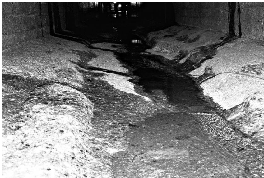
Slika 16: Poškodbe dna obtočnega prodnega izpusta (Jacobs et al., 2001: str. 36)
