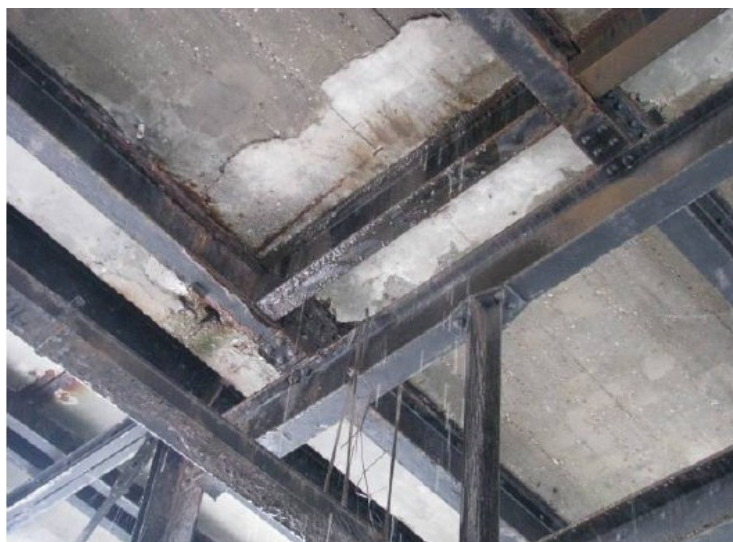
Sl. 3: Zamakanje na mestu dilatacije
