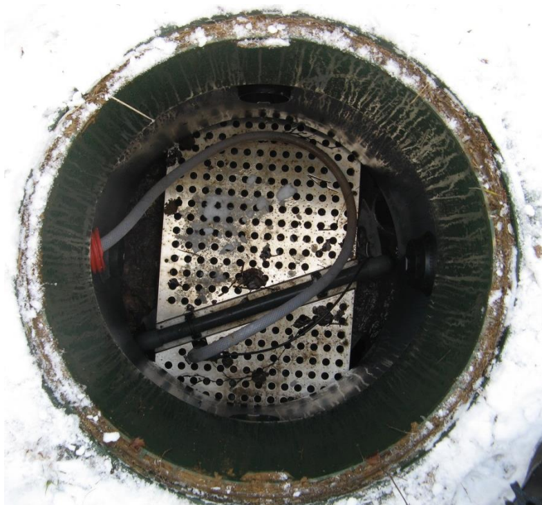
Slika B.2.8: Pogled v jašek, levo merilno mesto vtok, desno merilno mesto iztok. ČN na Ermanovcu, 10. 2. 2013
