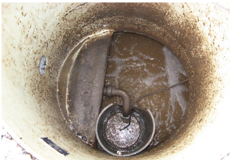
Slika B.2.9: SBR reaktor (faza mešanja in vpihovanja) in hkrati merilno mesto iztok. ČN na Valvasorju, 10. 2. 2013.
