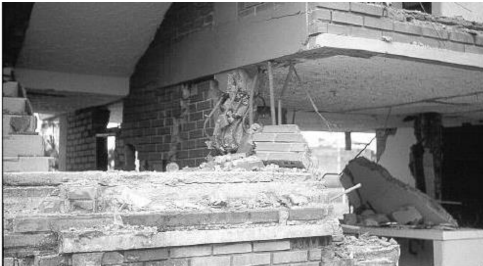
Slika 57: Poškodba kratkega stebra zaradi stopniščnega podesta [30]
