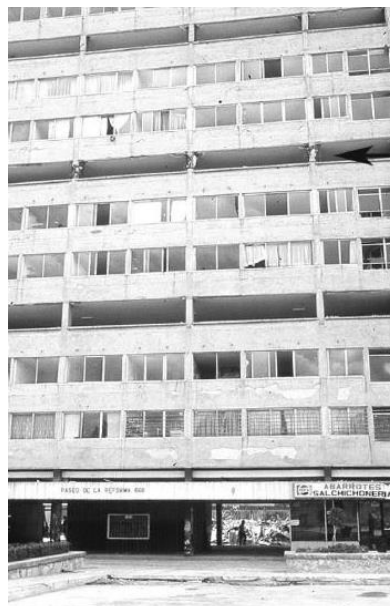
Slika 52: Stanovanjski kompleks, porušitev stebrov [30]
