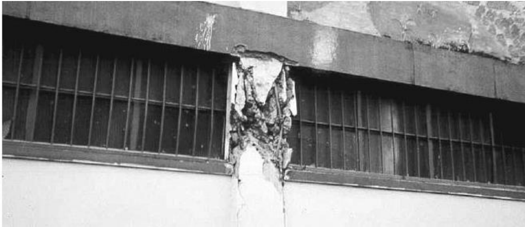
Slika 48: Realna porušitev ujetega stebra [30]
