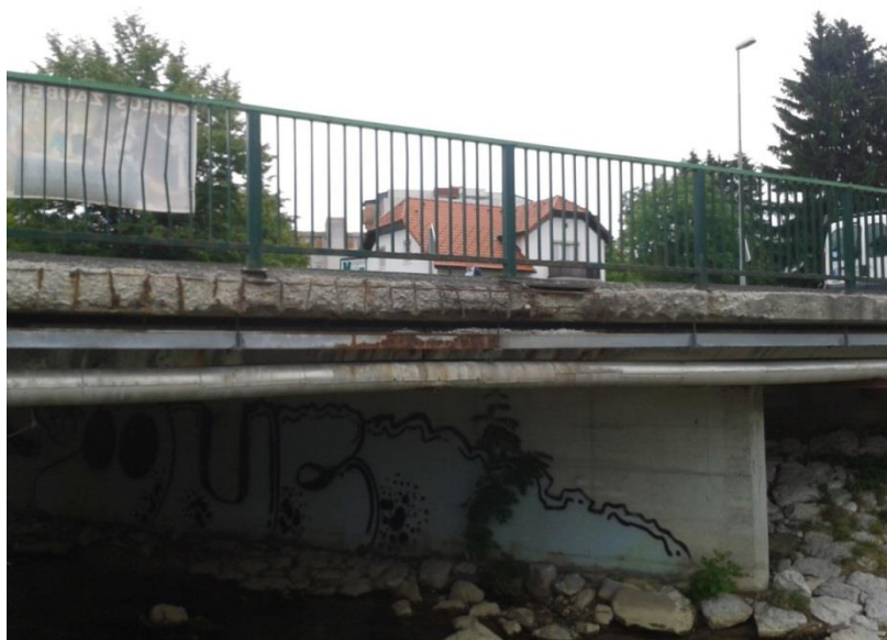
Slika 2: Primer korozije armature na cestnem mostu
