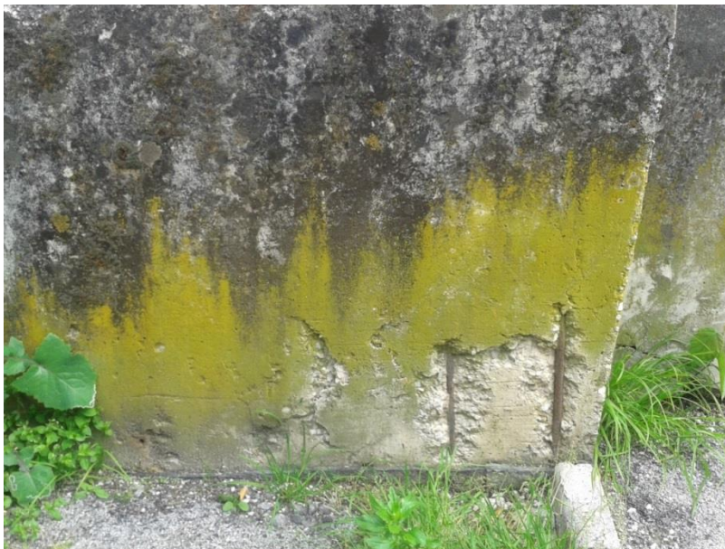
Slika 8: Nastanek mahu in lišajev, najverjetneje kot posledica karbonatizcije betona
