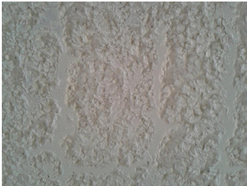
Slika 6: Posledice kontinuirne kristalizacije soli na stropu cestnega podhoda
