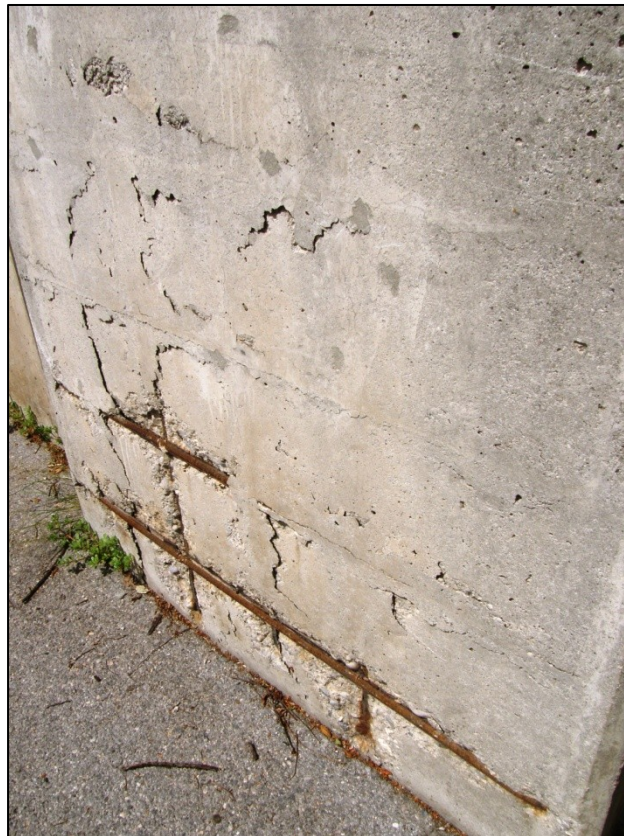
Slika 1: Primer poškodovanega armiranobetonskega stebra zaradi zunanjih vplivov
