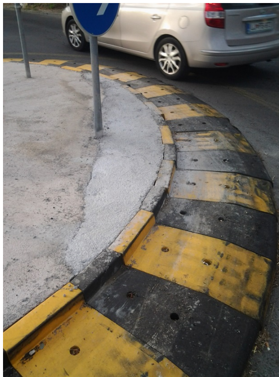
Slika 36: Potreba po sanaciji
