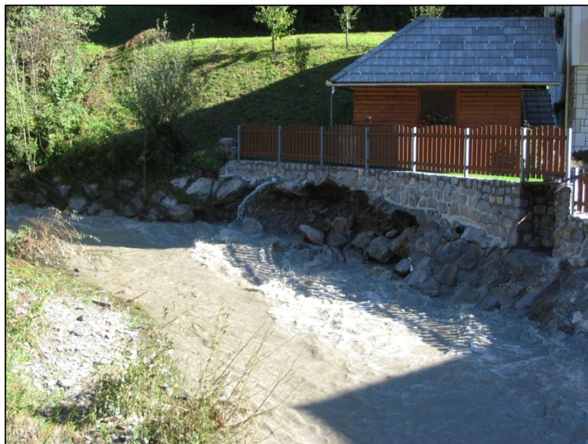
Slika 2.8: Poškodba levoobrežnega zidu iz kamna v betonu po poplavah v Železnikih, leta 2007 (arhiv VGP, d.d., Kranj)
