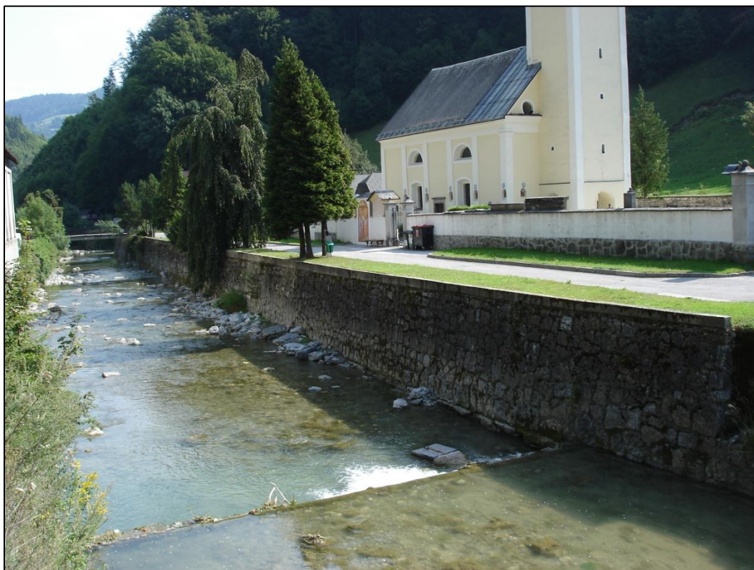
Slika 2: Desnoobrežni kamnito-betonski zid in poškodba (desni rob slike), pogled dolvodno.
