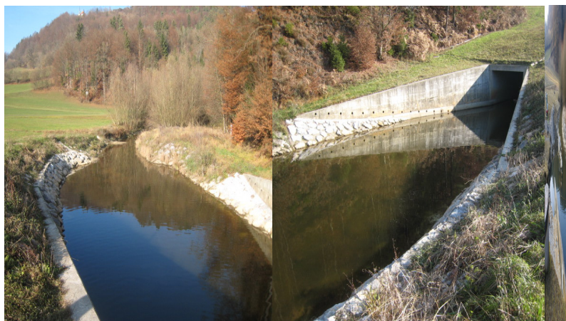
Slika 12: Podslapje talnega izpusta
